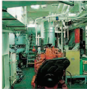
la salle des moteurs engine room
